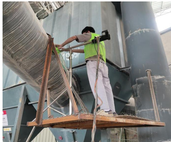
粉尘废气处理前采样
